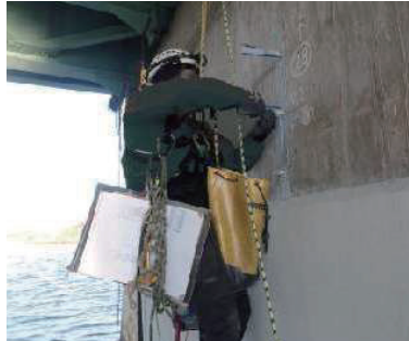
ひび割れ注入工
